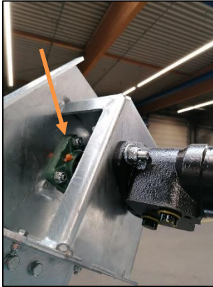
Abtransport-Förderband 1 (links + rechts)
